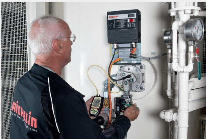
Bild 6: Zustandsüberwachung durch einen Service-Techniker
